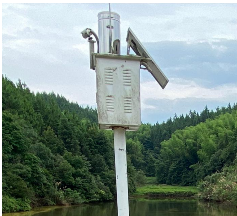
图 4.9-1 一体式水位雨量视频遥测站
